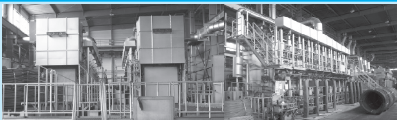
▲ 自動制御された無酸化熱処理炉
