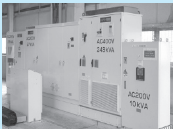
▲ トランスファ制御装置を更新
